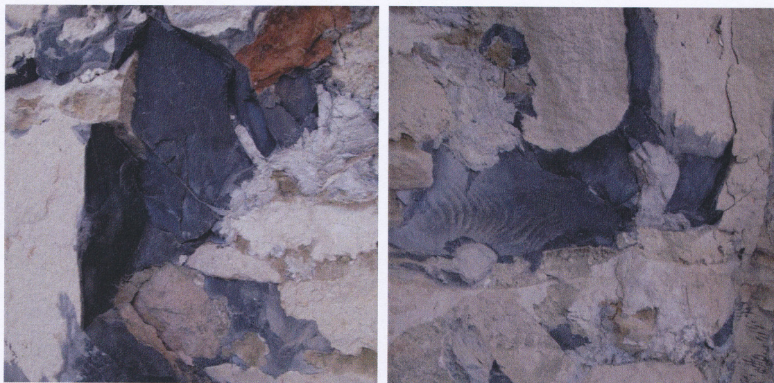
Coulis noir visible au sein du remplissage des maçonneries. Notons les parties en gris clair correspondant aux zones de feuilletage du coulis.
