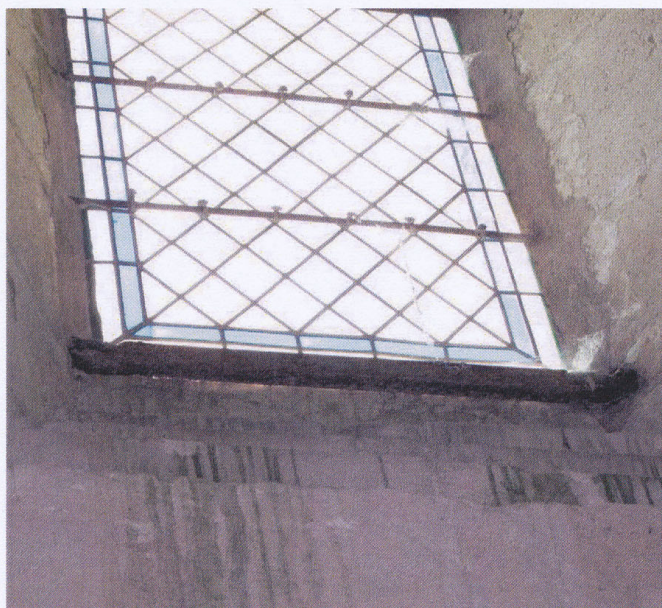
Défaut d'étanchéité en partie basse Armatures rouillées
