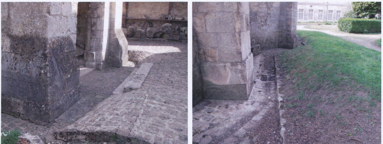
Développements biologiques importants au niveau des soubassements de la chapelle dont le sol est plus bas que le terrain environnant
