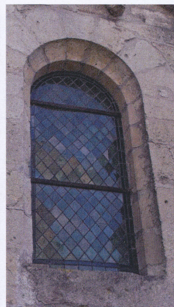
Vitrail déformé côté nord Appui de baie horizontale
