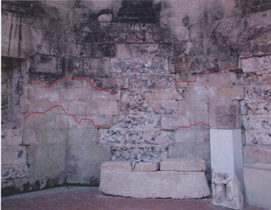
Colonisations biologiques à l'intérieur de la chapelle : en partie inférieure mousse et lichens, en partie supérieure algues noires
